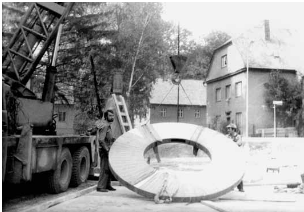
Obr. 7_ Prstenec – instalace, ocel, nerezová ocel, elektromotor, 360 × 300 × 300 cm, telekomunikační ústředna, Česká Lípa, 1983, foto archiv autora
